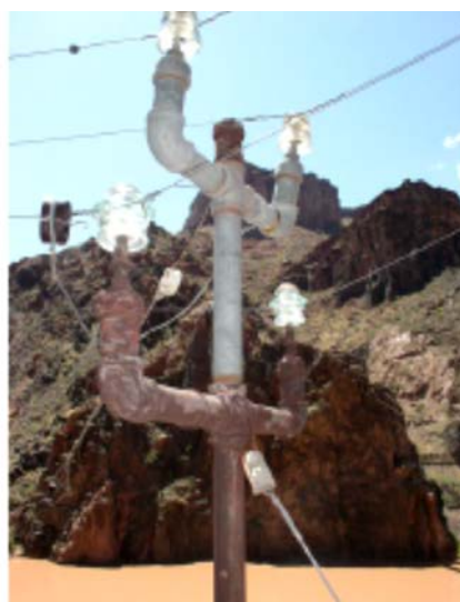
Εικόνα 5.1.α: Εγκατεστημένο τηλεφωνικό δίκτυο
