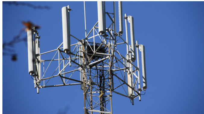
Εικόνα 2.5.β: Κεραία-σταθμός εκπομπής ασύρματου σήματος
