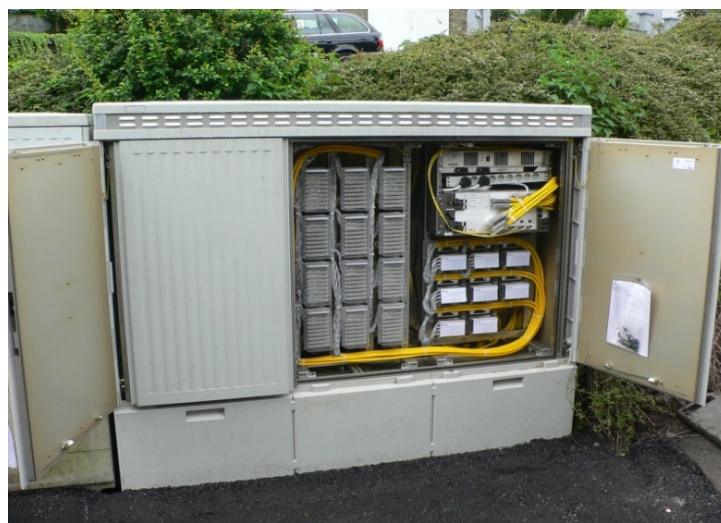
Εικόνα 5.1.4.1.β: Εξωτερικό DSLAM
